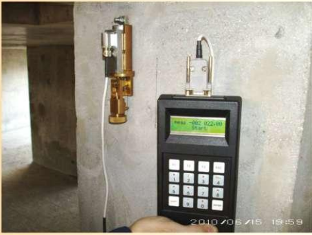
Струнный тензодатчик на железобетонной несущей конструкции
