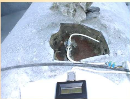
Струнный тензодатчик на участке газопровода в г.Ямбурге
